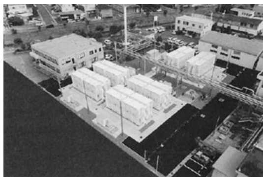
サーラ浜松蓄電所
