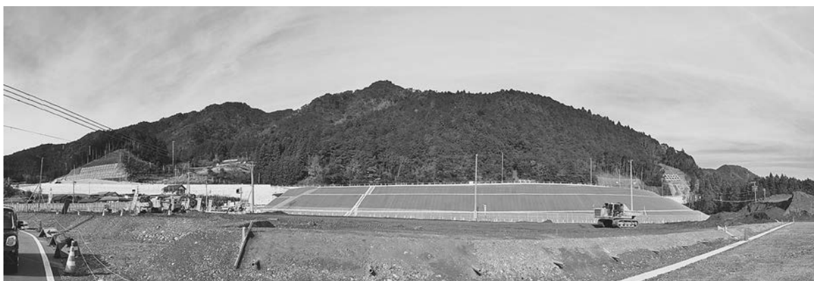
完成目指して追い込み段階の佐久間川合インターチェンジ （リニア対策課撮影）
