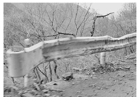
落石の激しさを物語るガードレール
